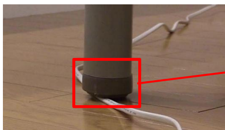
電源コードを踏みつけている様子
