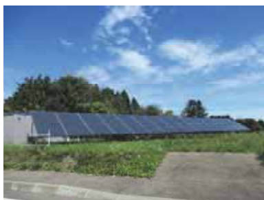
32：太陽光発電施設
