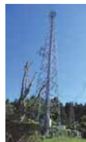
36：携帯電話通信施設
