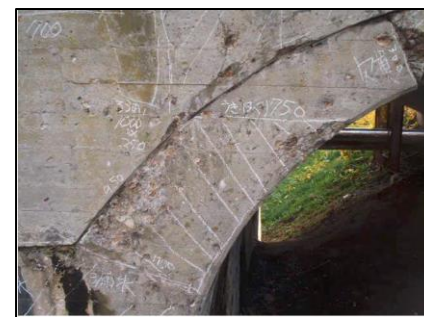
【アーチ部クラック】
