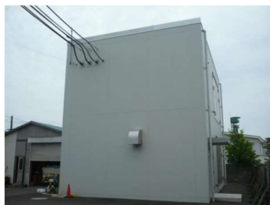
駒場町変電所
