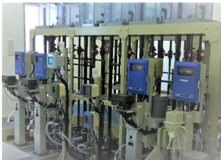
自動水質測定計器
