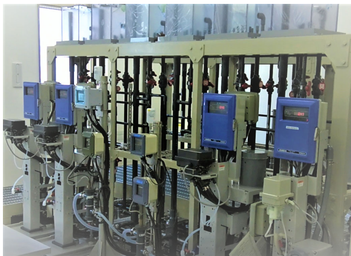
自動水質測定計器
