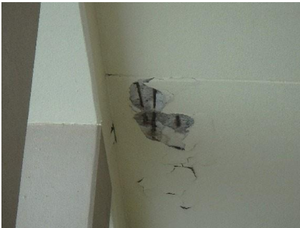
湯浜団地(2号棟)：鉄筋露出
