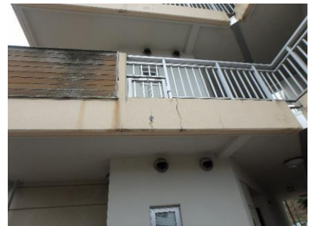
弥生団地(特公賃)：鉄筋露出，ひび割れ
