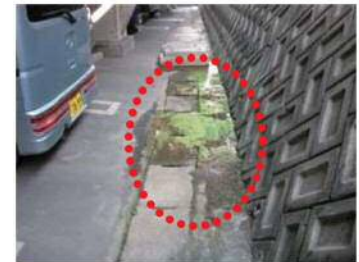
湧水部分にコケが生えている擁壁
