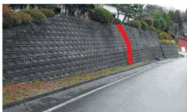
擁壁下端のハラミ出し
