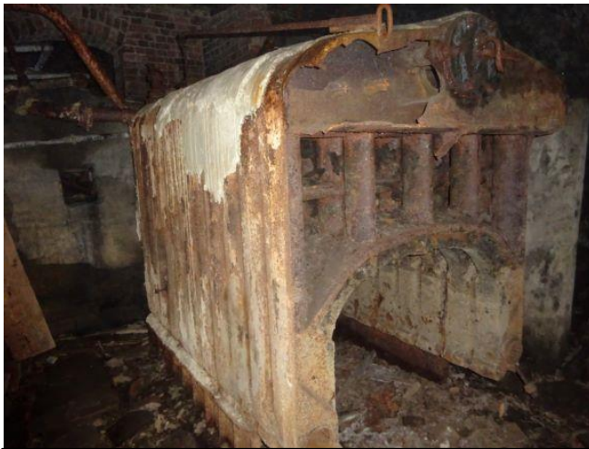
⑯地下ボイラー
