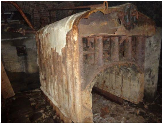
⑯地下ボイラー（WATER LINE 社 1901 年製） ※確認中
