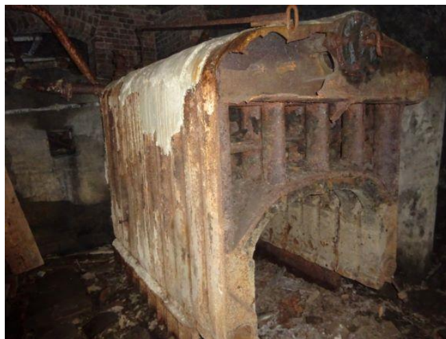
⑱地下ボイラー ※保留
