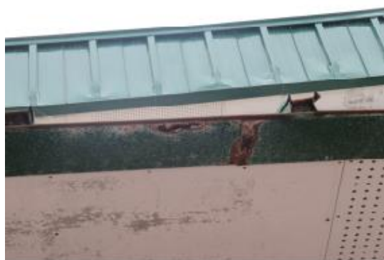
軒先・屋根腐食
