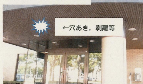
天井板囲い込み部分の劣化
