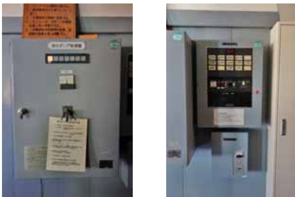
消火ポンプ制御盤・火災受信機
