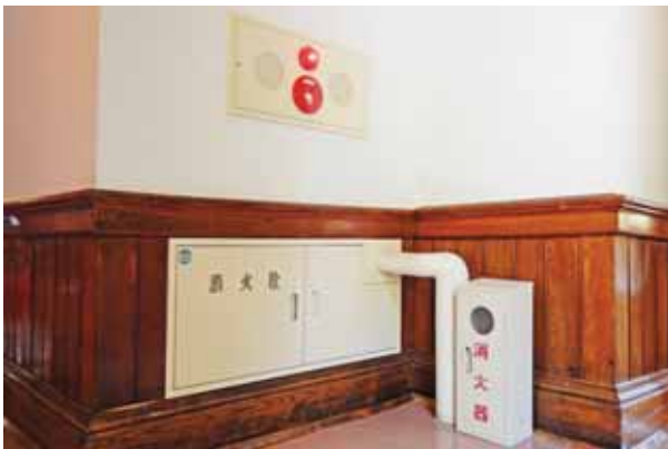
屋内消火栓、発信機、消火器
