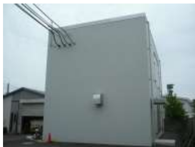
駒場町変電所
