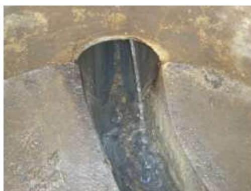
劣化による隙間からの侵入水
