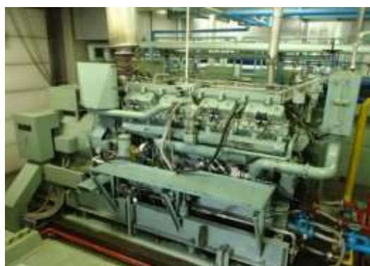
ガス発電設備
