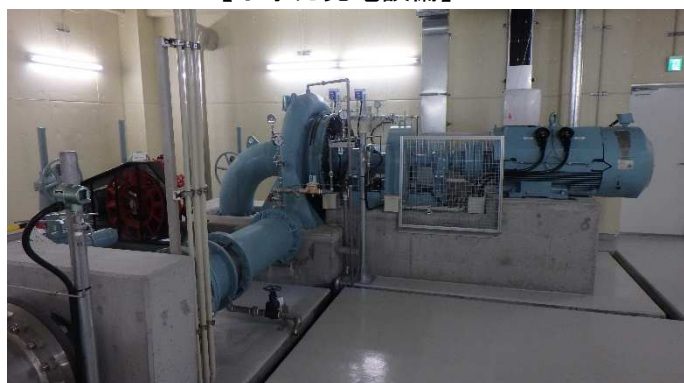
【小水力発電設備】
