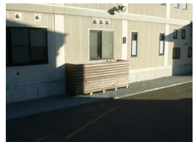
空調設備を目隠しして周囲の 景観に配慮した事例
