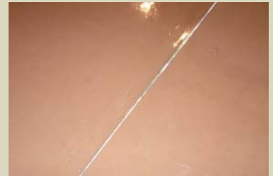
塩ビシートの浮き(本館2階 演壇)
