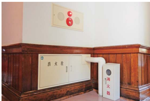
写真 4-1. 屋内消火栓、発信機、消火器
