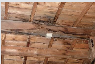
雨漏り(本館 小屋組)
