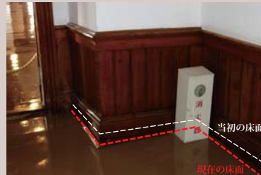
床の不陸(本館2階 廊下)
