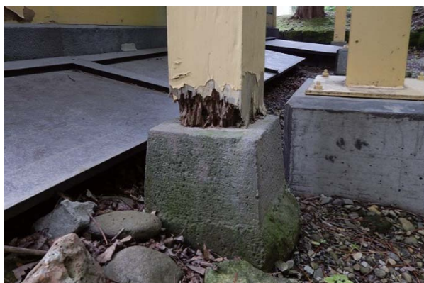
柱根の腐朽（本館突出部）
