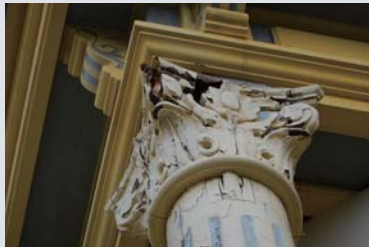
柱頭の腐朽(本館 西側車寄せ)
