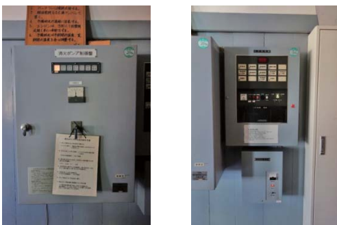
写真 4-3. 消火ポンプ制御盤・火災受信機
