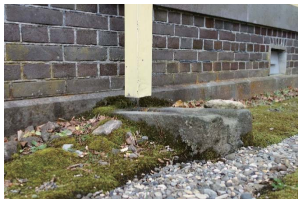
樋受石の不陸（本館西側）
