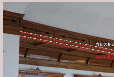
天井の垂下(本館2階 大広間)
