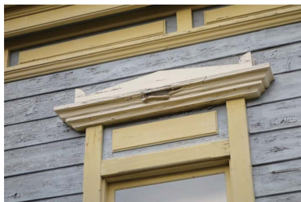
窓飾りの腐朽（本館東側）
