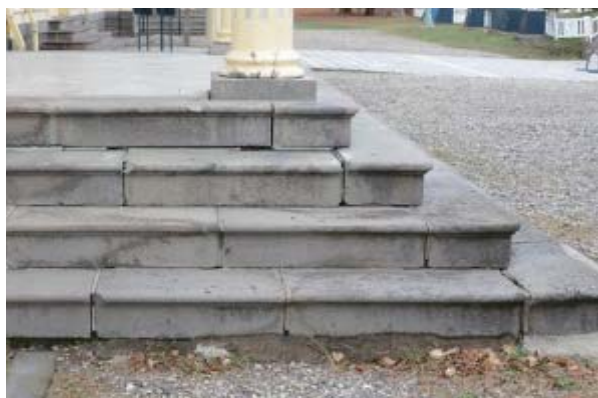
石段のゆるみ（本館車寄せ）
