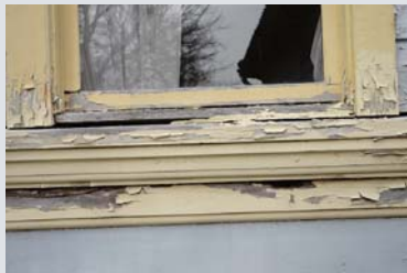
窓台の腐朽(本館 東面)
