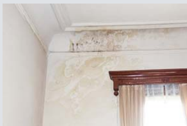
漆喰の汚損・割損(本館1階 予備室)
