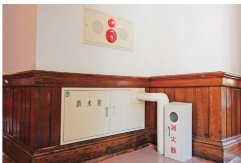
写真 4-1. 屋内消火栓、発信機、消火器
