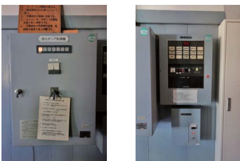
写真 4-3. 消火ポンプ制御盤・火災受信機
