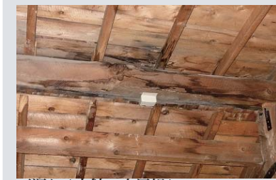
雨漏り (本館 小屋組)
