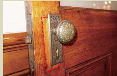
建具金物のずれ (本館 1階 会議所役員室)
