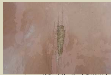
リノリウムの破損 (本館 1階 会議所役員室)
