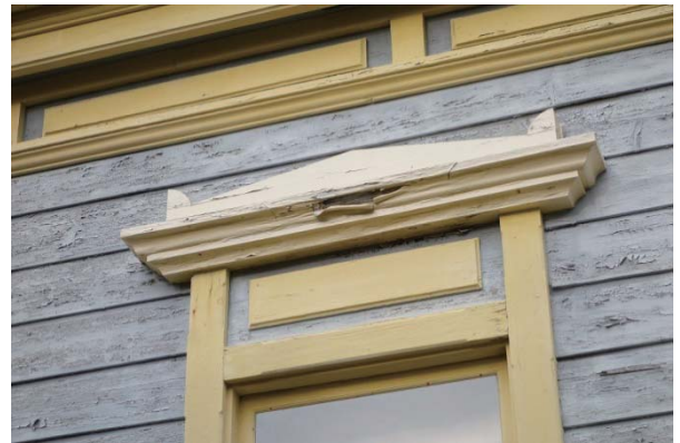
窓飾りの腐朽（本館東側）
