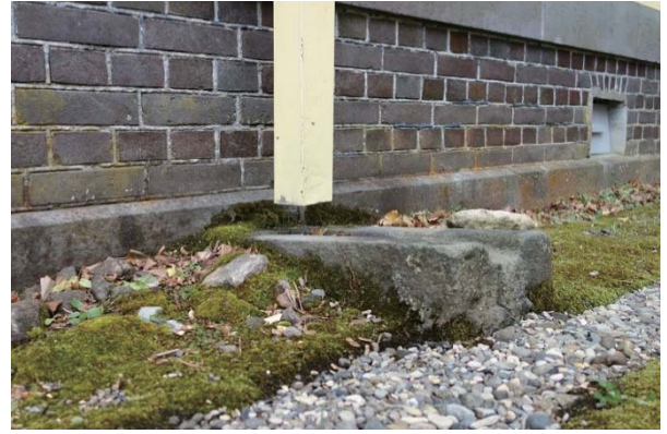
礎受石の不陸（本館西側）
