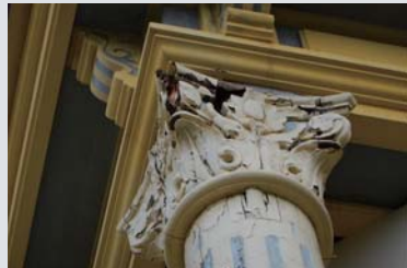
柱頭の腐朽 (本館 西側車寄せ)
