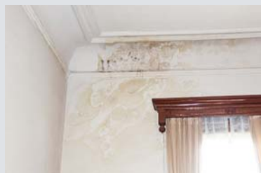
漆喰の汚損・割損 (本館 1階 予備室)
