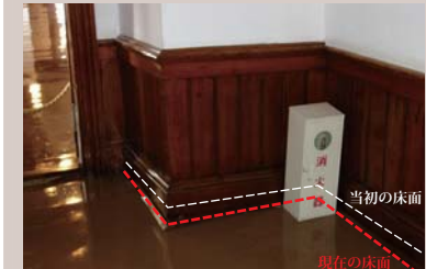
床の不陸 (本館 2階 廊下)
