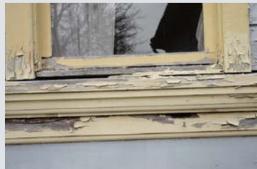
窓台の腐朽 (本館 東面)
