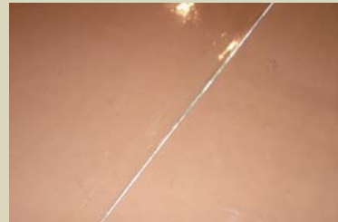
塩ビシートの浮き (本館 2階 演壇)
