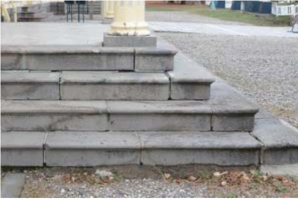
石段のゆるみ（本館車寄せ）
