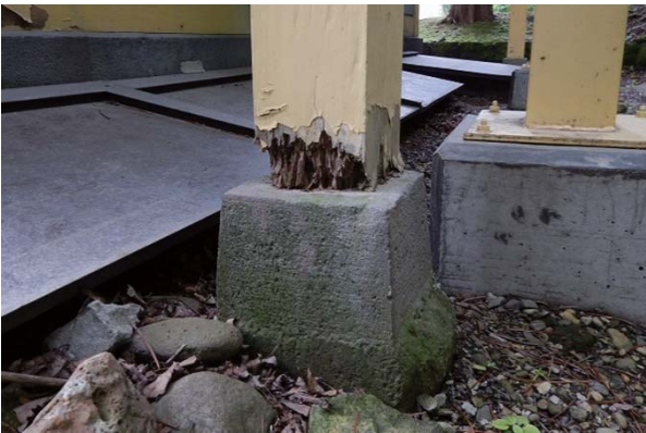
柱根の腐朽（本館突出部）
