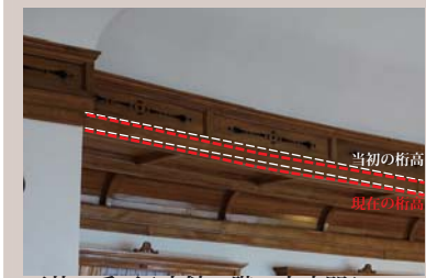
天井の垂下 (本館 2階 大広間)
