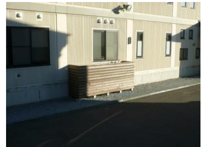
空調設備を目隠して周囲の 景観に配慮した事例
