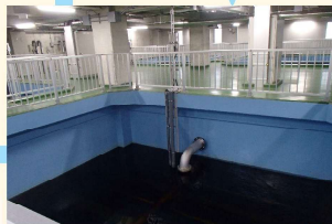
高区急速ろ過池
