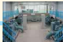
汐泊導水ポンプ場
