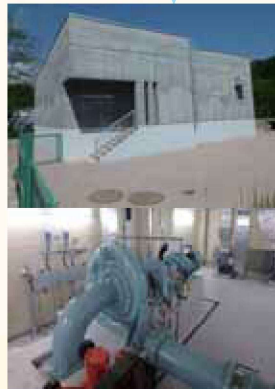
赤川高区浄水場水力発電所
