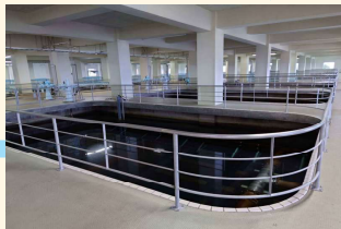
旭岡急速ろ過池
