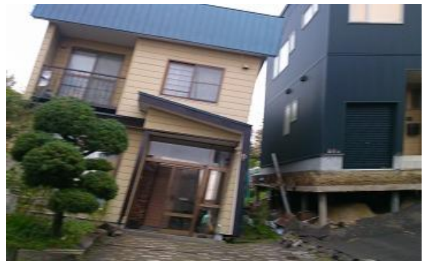
(b) 地盤の沈下と住宅の傾斜
