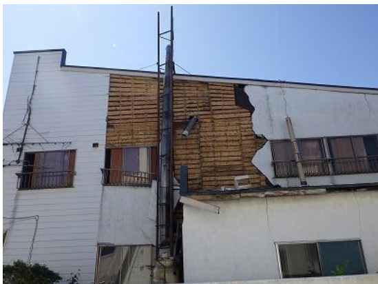
(c) 外壁の落下
