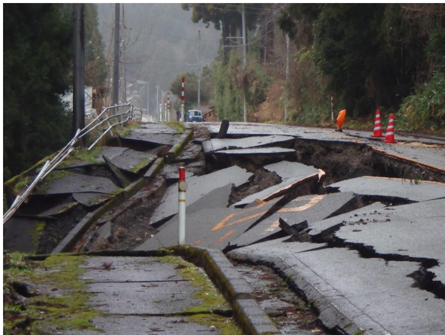
道路被災状況（珠洲市）
