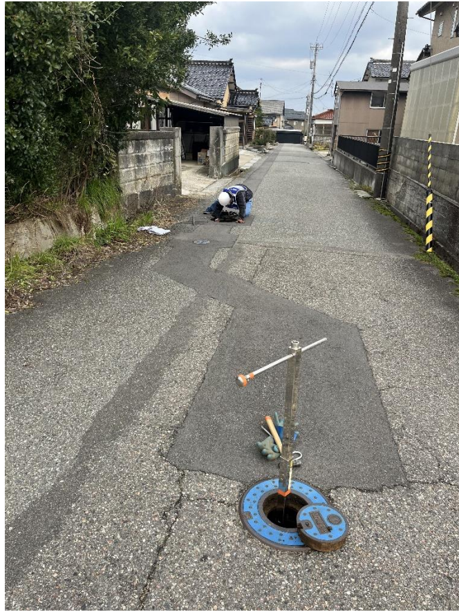
漏水確認（七尾市）
