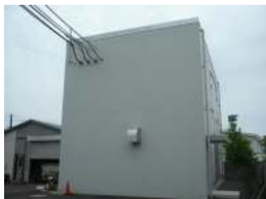
駒場町変電所
