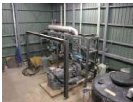
温泉供給ポンプ
