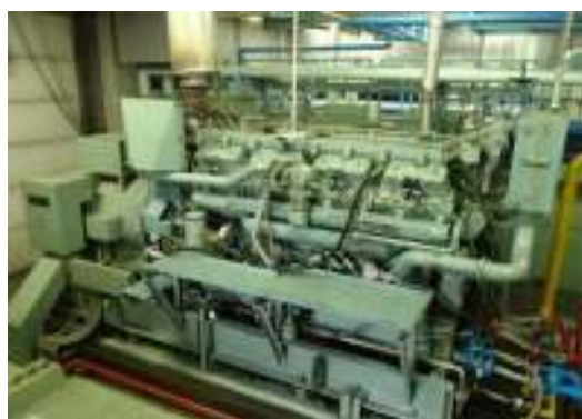
ガス発電設備
