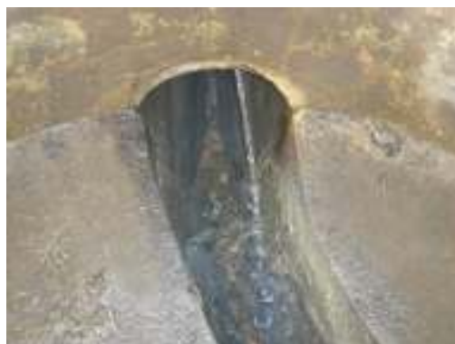
劣化による隙間からの侵入水
